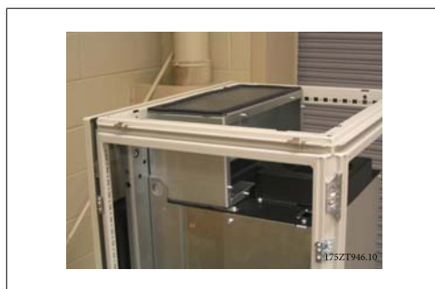
Рисунок 3.46: Установленный верхний воздухоход
